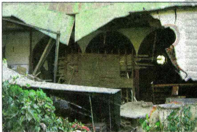
Imagen que muestra el destrozo lateral de la iglesia de Lolol, construida en 1915.
